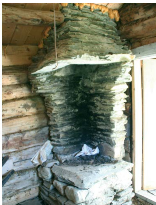
Det var akkurat plass til ei lita grue ved siden av inngangsdøra.
