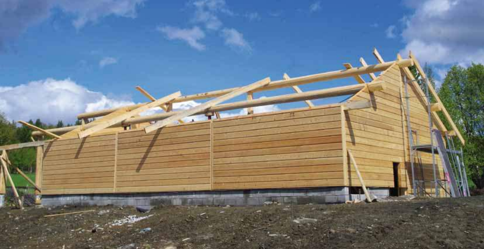
Oppsett av nytt sæterfjøs der veggane er laga i tømmer og som element. Rask byggeprosess og fint bygg. Foto: Jakob Trøan, Alvodal Skurlag.
